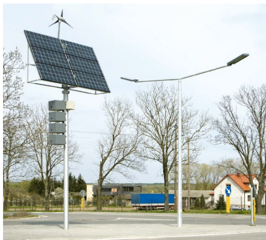
Rys.2. Oprawa LED systemu SSOD zamontowana na drodze
