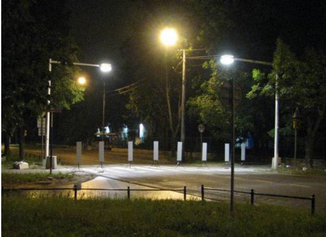
Rys.17. Oprawy Calypso Zebra zainstalowane na przejściu dla pieszych
